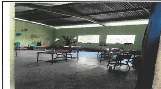
Foto 3: interior del Aula 1, se sustituirá el piso de cemento por cerámico, se repellarán y pintarán los muros, se instalarán ventanas de PVC con vidrio y se suministrará cableado eléctrico.
